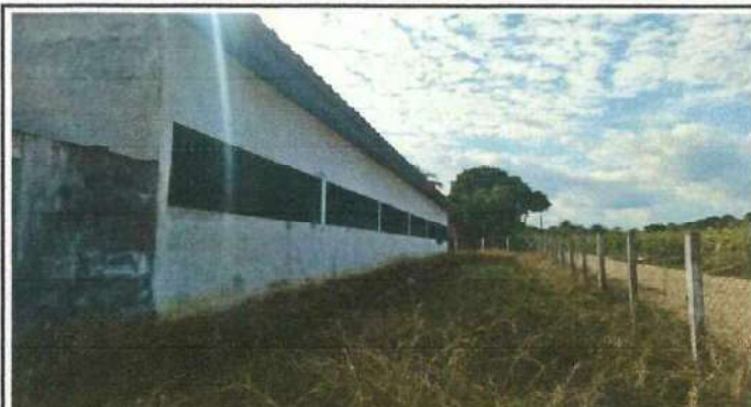
Foto 2: DETERIORO DE LA PINTURA EN MURO EXTERIOR POR LAS SITUACIONES CLIMATICAS, EL CUAL ES NECESARIO DARLE SOLUCION
