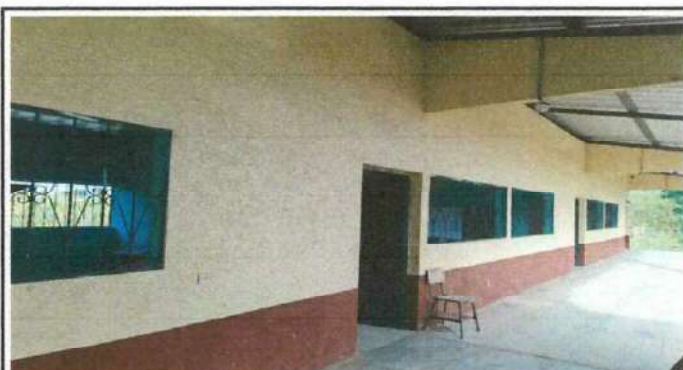
Foto 4: PINTURA EN MURO EXTERIOR, PARTE FRONTAL DEL ESTABLECIMIENTO
